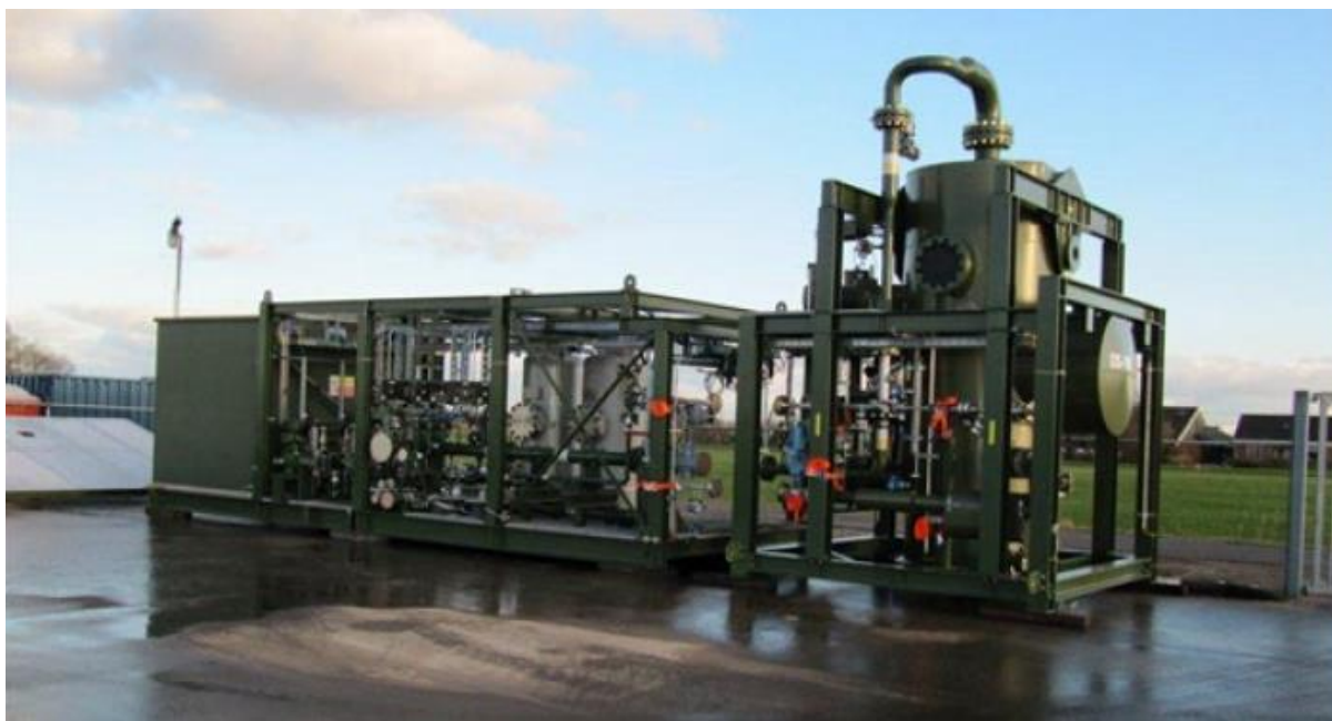
Figuur 26. Voorbeeld productie-installatie
